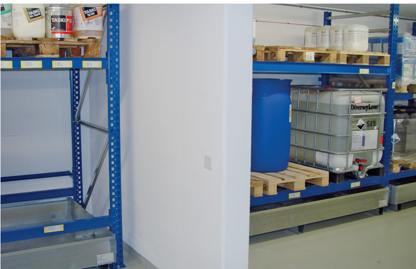
Getrenntlagerung (Schirmmauer und getrennte Auffangwannen) im gleichen Brandabschnitt
